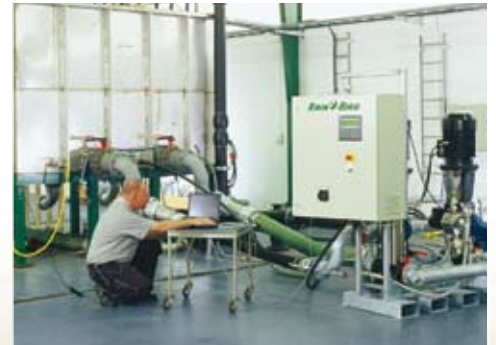
Teste de uma Estação de Bombagem na Rain Bird Suécia
